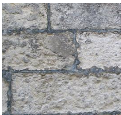
Reprise des joints au ciment ayant entraîné la dégradation de la pierre
