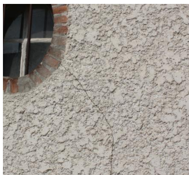
Finition de l'enduit inappropriée, comme par exemple l'enduit écrasé
