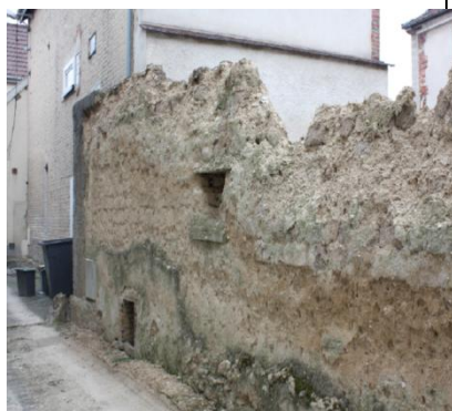
Le manque d'entretien, la mise en place d'enduit non respirant entraînant des stagnations d'eau importantes au cœur de la terre entraînent, à court ou moyen terme, la ruine du mur.
