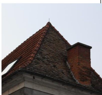
Remplacement de la tuile plate de terre cuite par de la tuile à emboîtement. Disparition des accessoires de toiture (épis de faitage)
